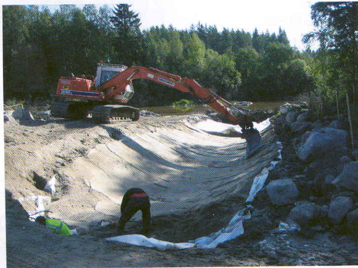
Bontoniittimaton päälle on asennettu suodatinkangas ja sen päälle tulevan taseus- ja suojakerroksen levitys on menossa.
