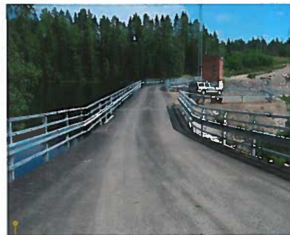
Ruskeakosken patosilta kunnostuksen jälkeen. Silta levennettiin ja kannen pintarakenteet ja kaiteet uusittiin.
