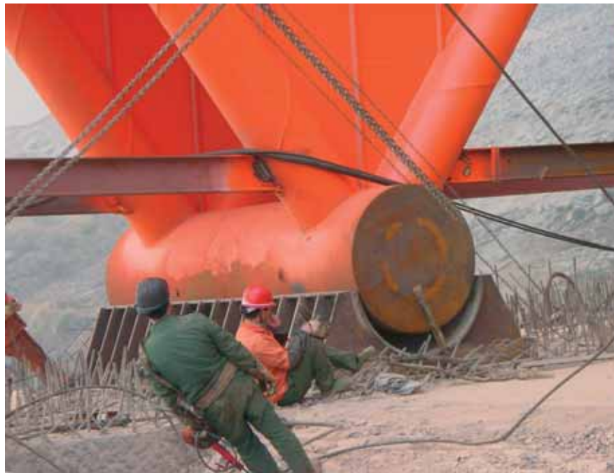
Kaarirakenteen päätylaakeri. Vasemmalta oikealle viettävä maanpinta on kuvassa oikaistu vaakasuoraksi, mistä selittyy vasemmanpuoleisen työmiehen vino asento.
