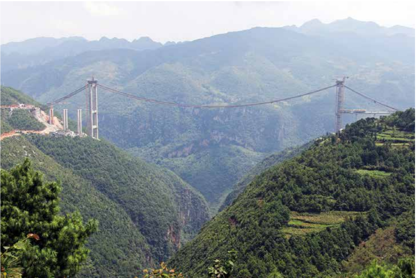
Puli-sillan yleiskuva. Pylonit on rakennettu ja riippuköydet asennettu paikoilleen. Kuvassa vasemmalla näkyy sivujänteen tukipilareita.
