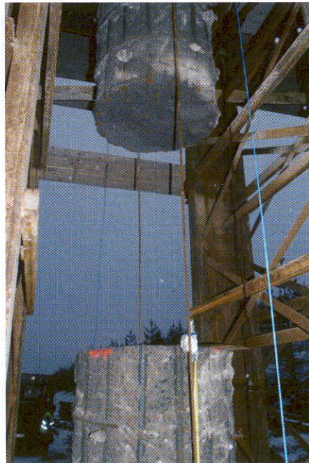
Katkaistu pilari ennen jatkamista.
