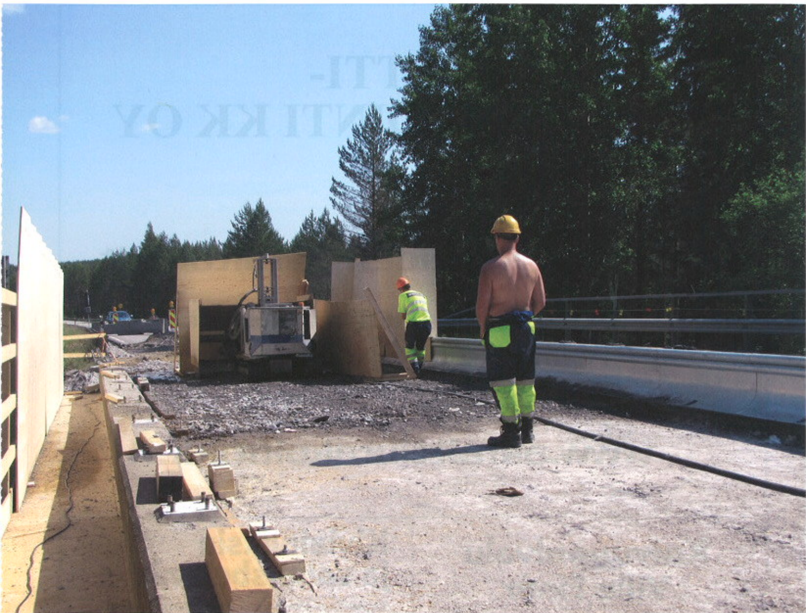
Pöytälahden ylikulkusilta, Liperi, kannen vesipiikkaus.
