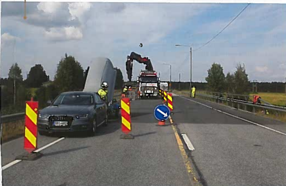
Kuvia viime vuosien Rambollin siltojen erikoistarkastuksista.
