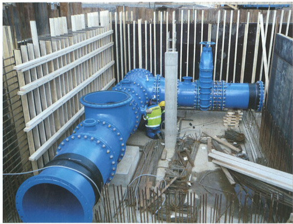
Siirtolinjalla olevan venttiiliaseman rakenteita. Venttiiliasemia on yhteensä 11.
